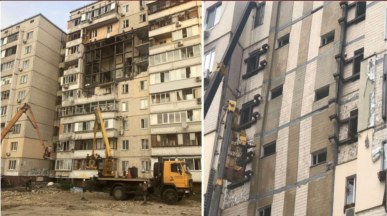
Рисунок 1 – Тимчасова конструкція підсилення будинку в Києві, пошкодженого внаслідок вибуху газу (2020 рік, [8])
