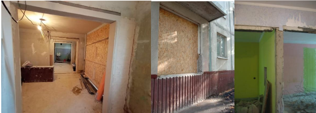
Рисунок 2. Самовільне влаштування прорізів в 5-ти поверховому панельному будинку
