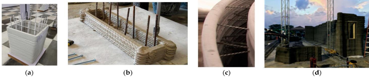
Рисунок 1 – Методи армування друкованого бетону, прийняті: а – WinSun; б – CyBe; с – CON; д - Печатні бетонні будівельні конструкції
