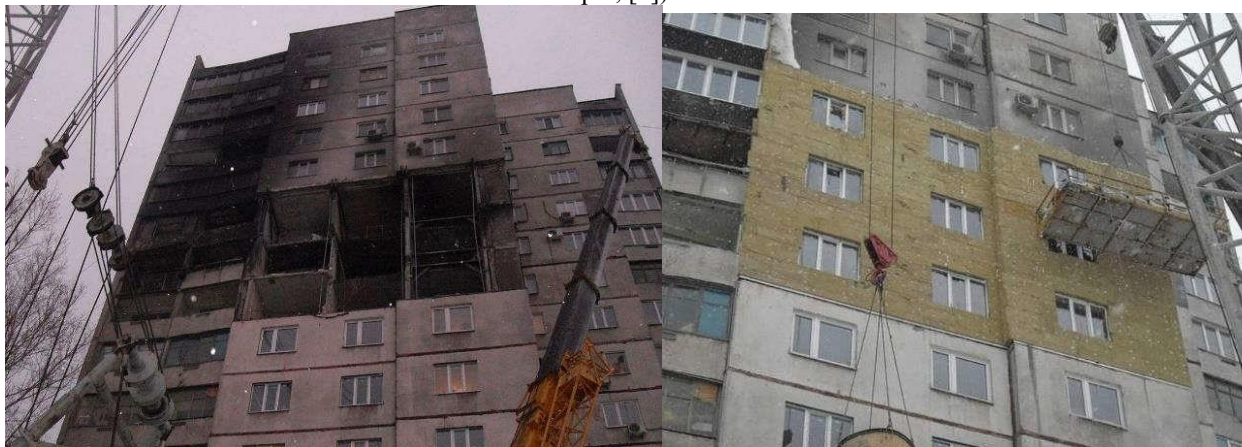
Рисунок 2 – Наслідки вибуху природного газу в шістнадцятиповерховому панельному будинку і загальний вигляд відновленого фасаду [9]
